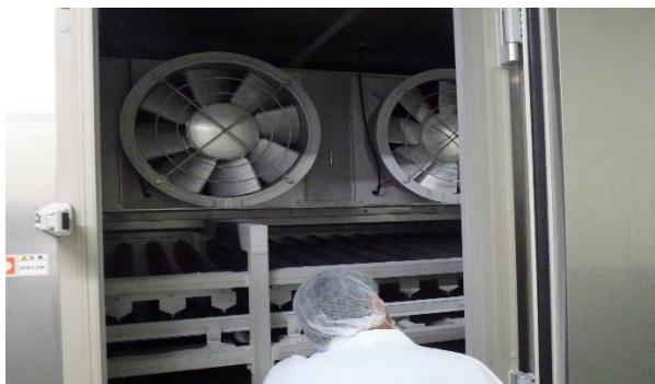
凍結機の内部
